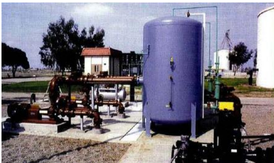
ระบบอัดแรงดันประกอบด้วยถังแรงดันอิ่มตัว (Saturation Tank) เครื่องอัดอากาศ (Compressor) แผงควบคุมอากาศ (Air Control Panel) และเครื่องสูบลมแรงดันสูง (HP Pumps)
